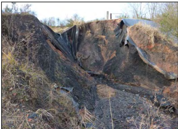
Dégradation du raccordement au bassin de décantation
